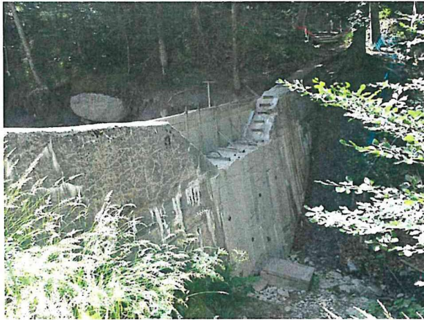
Barrage béton avec cunette obstruée
