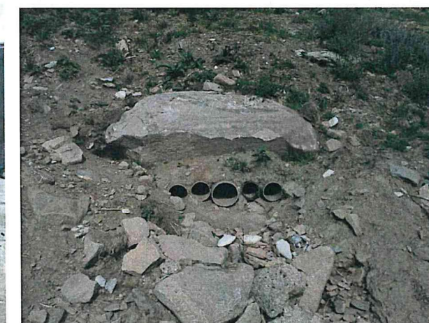
Sortie de la vidange et des drains cuvette et digue
