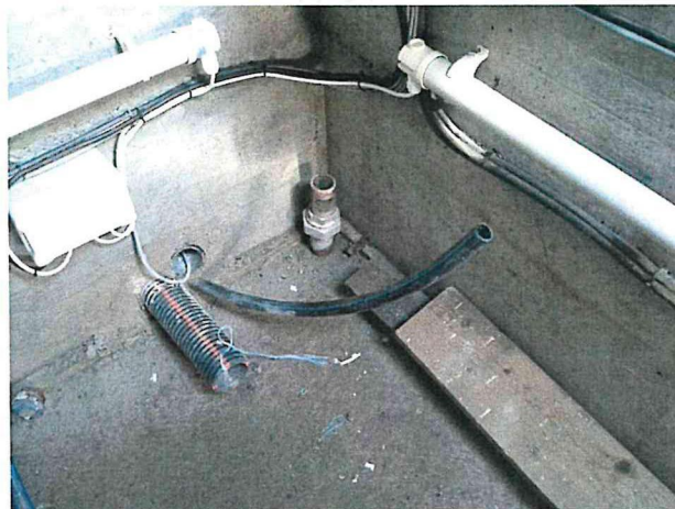
Canalisation pour l'usage agricole
