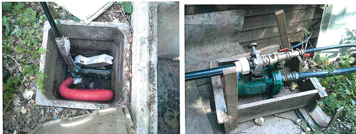
Petit regard à côté du captage Ravin Terre Noire
