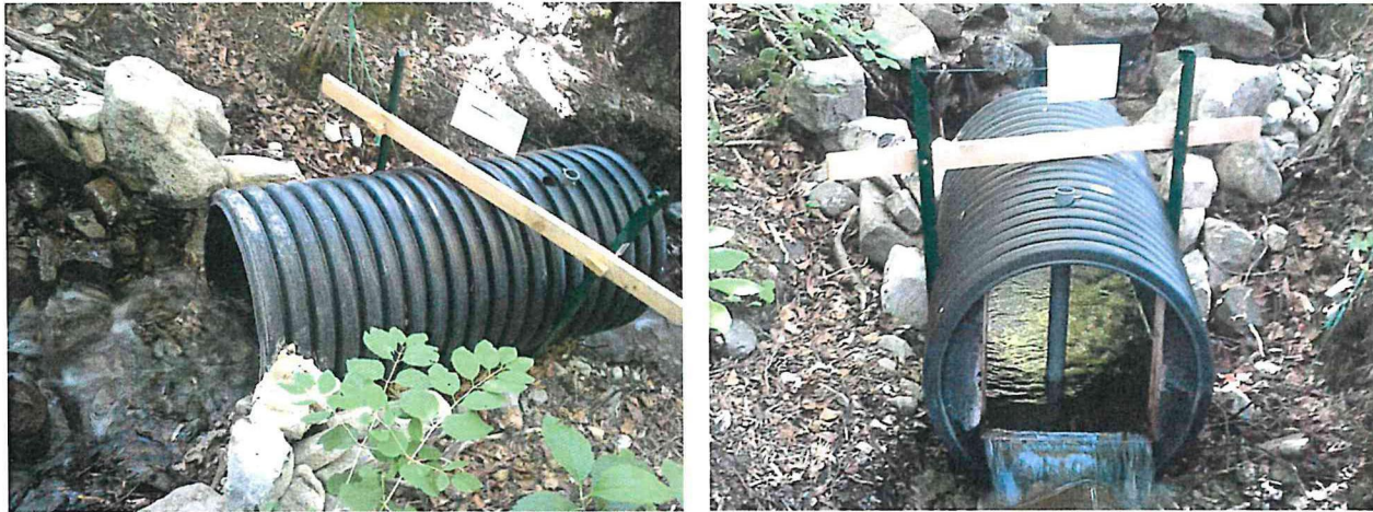
Station hydro temporaire Ravin terre Noire
